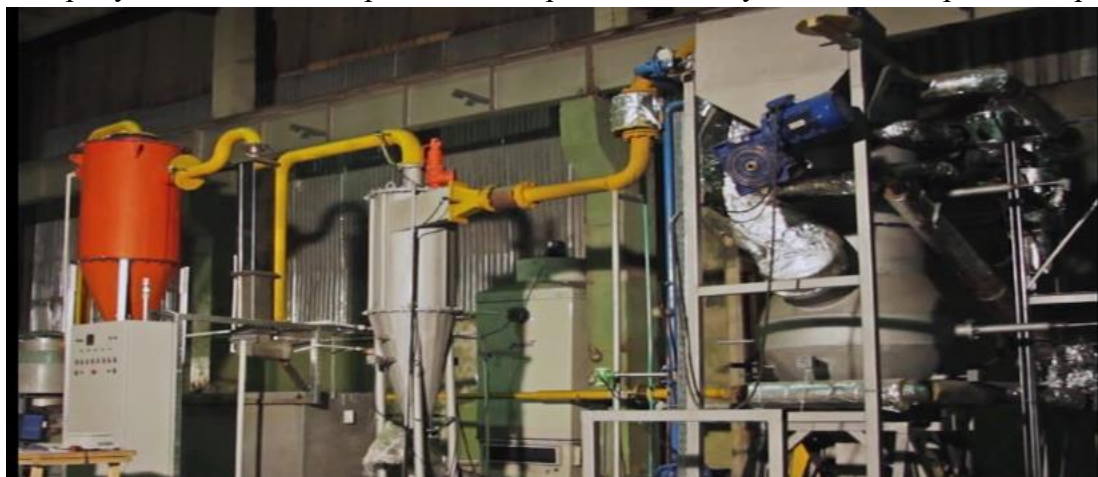
Рисунок 2. Фрагмент модуля технологического комплекса в целевом исполнении для генерации электроэнергии (Мини ТЭС на отходах).
